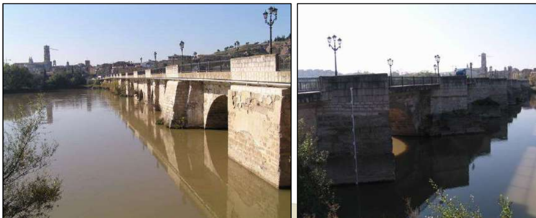
Ilustración 11. Fotografías de la estación de aforo del río Ebro situada en el término municipal de Tudela. Imágenes obtenidas de la página web del SAIH de la Confederación del Ebro.
